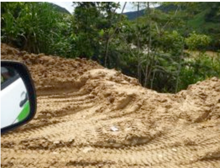
Una parte del camino público en pésimo estado por la circulación constante de vehículos pesados. Foto: diario de campo.
