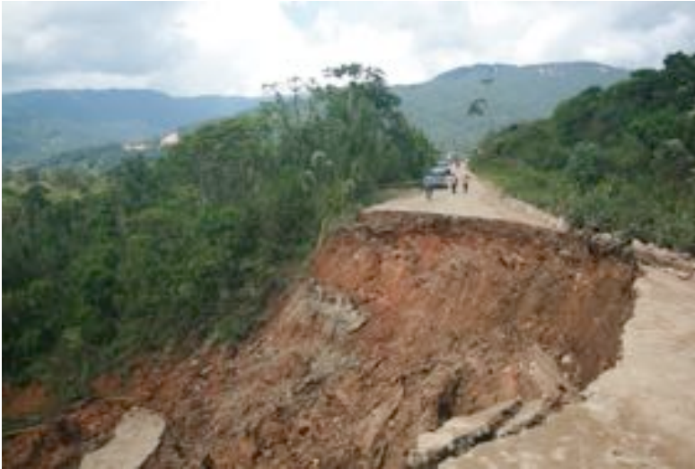
Ejemplo de deterioro de la vía comunal por el tráfico incesante de máquinas pesadas y volquetas. Foto: diario de campo.
